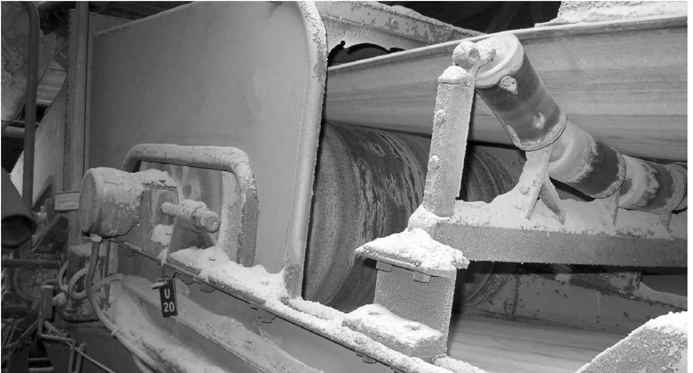
Applicazione: Fertilizzanti. Un mototamburo di 35 anni che lavora senza problemi in ambiente particolarmente corrosivo.
